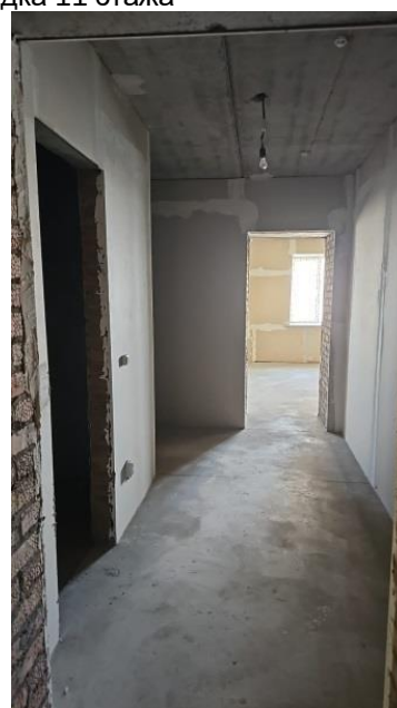
Фото 4. Состояние внутренней отделки кв. 66
