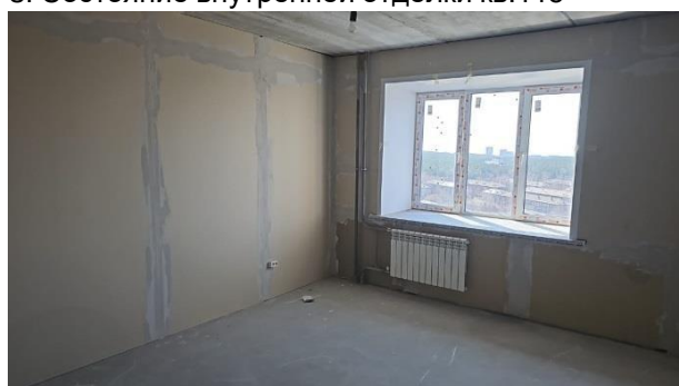
Фото 5. Состояние внутренней отделки кв.118
