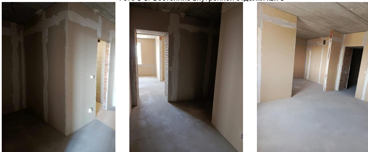
Фото 6-8. Состояние внутренней отделки кв.70
