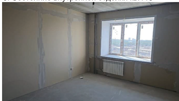
Фото 5. Состояние внутренней отделки кв.118
