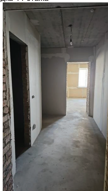
Фото 4. Состояние внутренней отделки кв. 66
